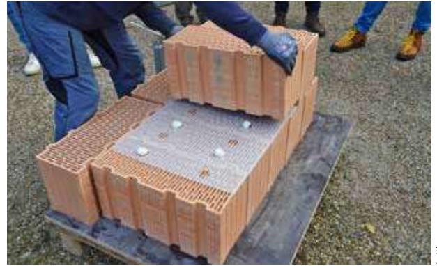
» The selective bonding of the tiles with fleece overlay » Die punktuelle Verklebung der Ziegel inkl. Vliesauflage
